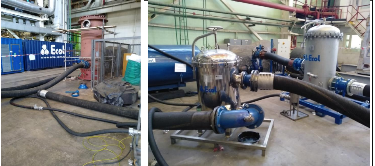
Фото 5.21. Підключення обладнання ECOL для промивання охолоджувача М-540.
