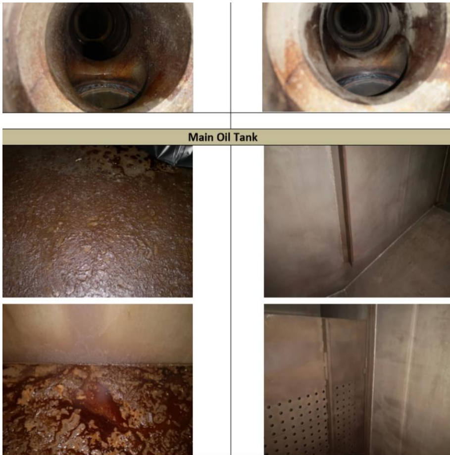
Фото 5.23 Конструкційні елементи головного оливного баку (ГМБ) до і після гідродинамічного очищення
